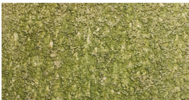
Kein Holzfaser-Dämmstoff: kühle Oberfläche, Tauwasser, Algen
