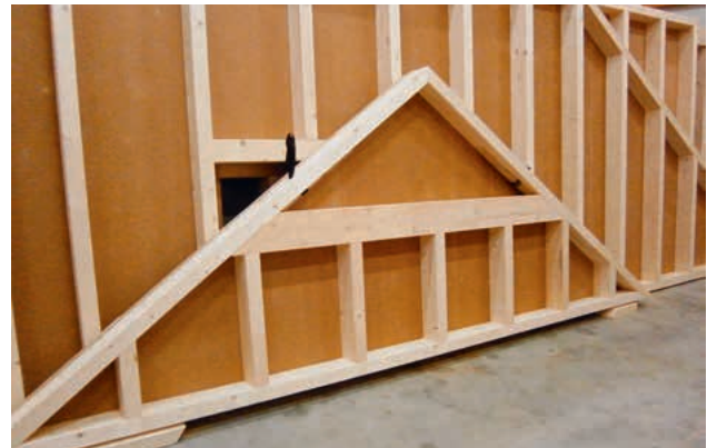
Fertig beplante Giebelwände bereit für die Verladung; Aussteifung während der Bauphase und Witterungsschutz
