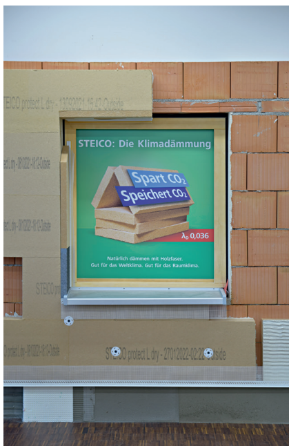
2 Demonstrationwand mit Holzfaser- WDVS auf Ziegelmauerwerk in der STEICO Akademie.
