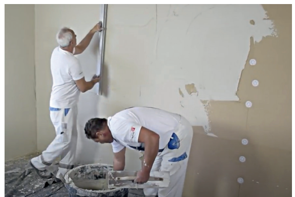
4f Aufbringen des Putzes: Nach Säubern der Dämmplatte wird zunächst der Unterputz, dann das Armierungsgewebe und schließlich der Oberputz aufgetragen.
