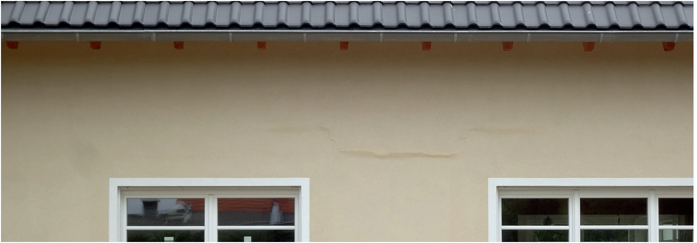
Ist die Holzbau-Konstruktion beim Geschosstoß nicht ausreichend dimensionsstabil und druckfest, kann das zu mehreren Millimeter starken Setzungen führen. Bei Putzoberflächen bedeutet das: Quetschfalten Foto: STEICO
